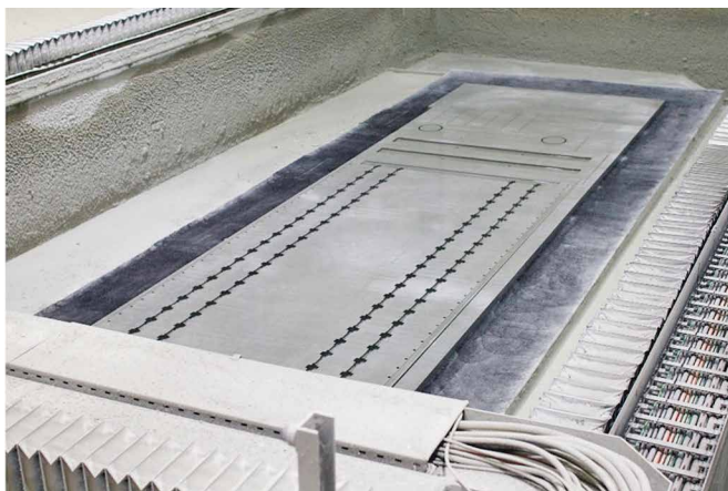
Bild 11 Tragkonstruktion der Hybridbrücke im 5-Achs-CNC-Bearbeitungszentrum Support structure of the hybrid bridge in the 5-axis CNC machining centre (CPC-AG)
