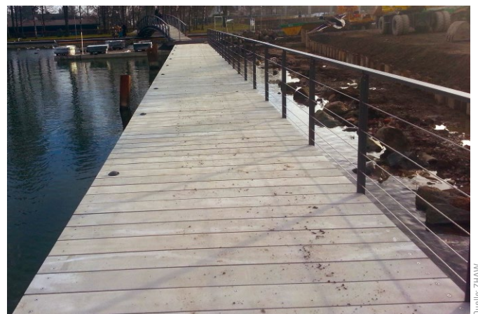
Bild 1 Beispiel eines Steges mit CPC Belag Example of a footbridge with cpc covering
